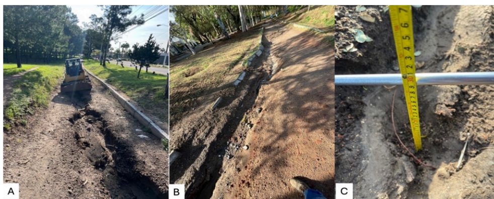
Figura 4. Erosión hídrica en el PMG, caracterizada por el arrastre de partículas del suelo debido al escurrimiento superficial de agua pluvial. A) Maquinaria tratando de corregir mediante aplanamiento. B) Aspecto general del deslave. C) dimensión de la pérdida del suelo.
